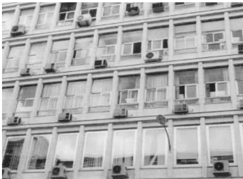
Fig. 8. Instal·lacions d'aire condicionat a la façana.
